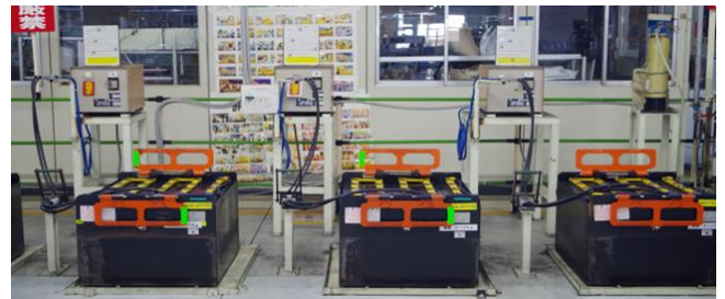
図 4-2 バッテリー充電場
