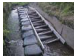
流れの速い傾斜のある水路に設置した魚道
