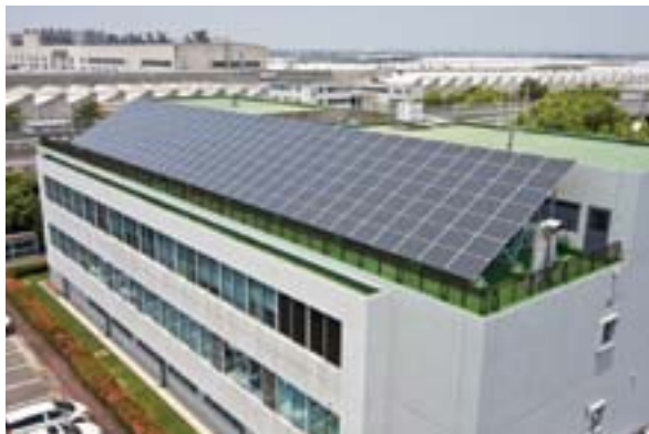
太陽光発電設備(トヨタ自動車堤工場事務館)
