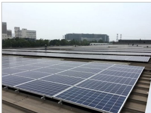
ユニット工場（1.6MW）
