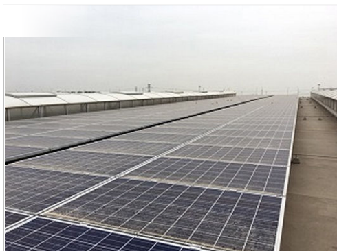
車両工場（10MW）
