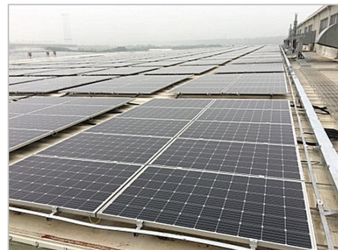
エンジン工場（5.0MW）
