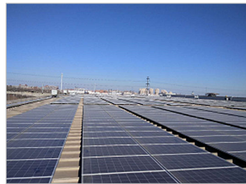
ユニット工場（1.5MW）
