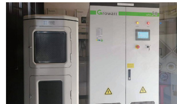
使用済みHVバッテリーを再利用した蓄電システム
