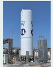
液体水素タンク
