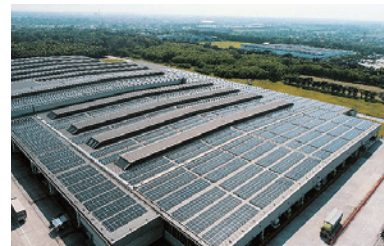
TMMIN 太陽光導入全景
